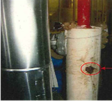
▲ 左が保温材ありの配管、右が保温材なしの配管、赤丸の箇所に亀裂・腐食が生じている
