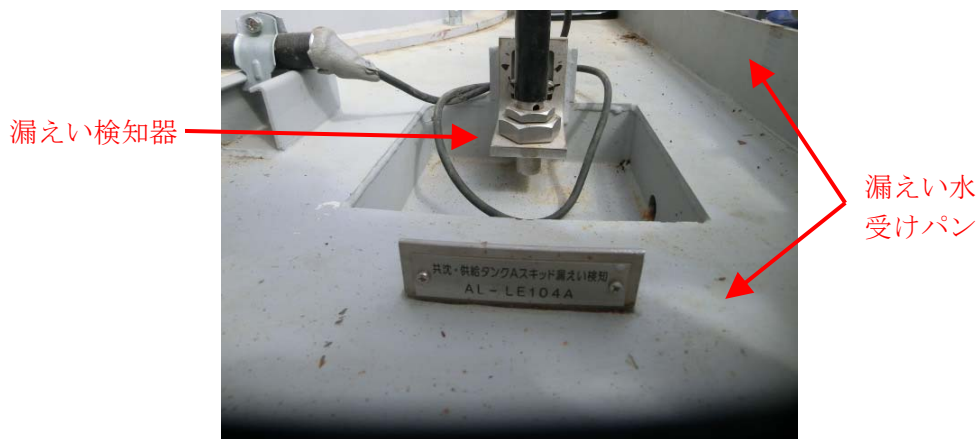
図3 漏えい検知器の設置状況（一例）
