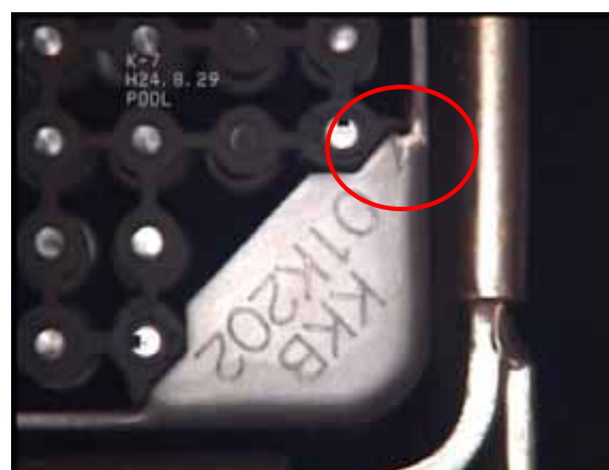
図 3 7号機の使用済燃料プールで確認されたクリップ接合部の状況
