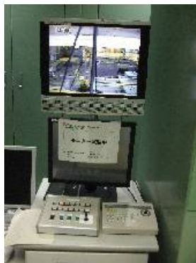
②監視用カメラ
