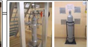
原子炉建屋地下4階 S/Cベント用空気ポンプ、 予備ポンペ
