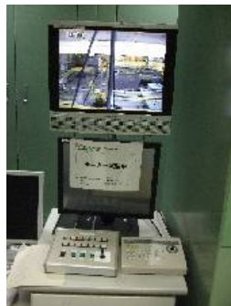
②監視用カメラ
