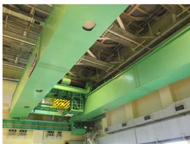
原子炉建屋クレーン
