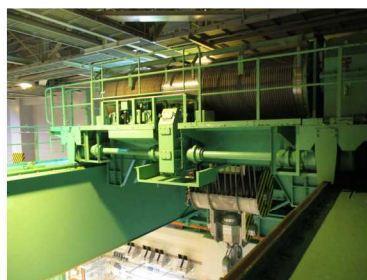
原子炉建屋クレーン外観
