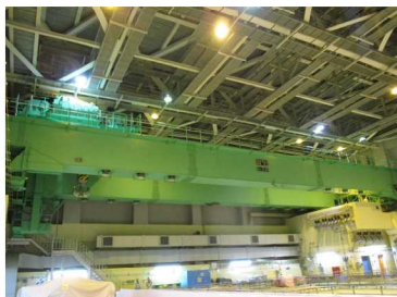
原子炉建屋クレーン
