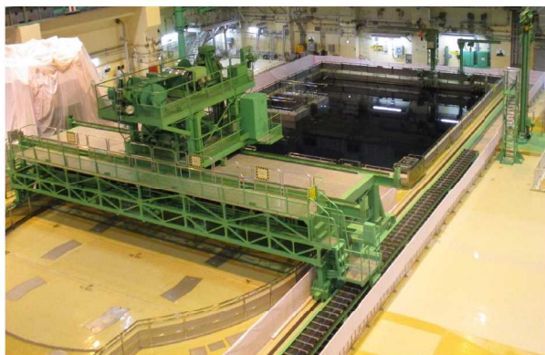
使用済燃料貯蔵プール周り(全体)
