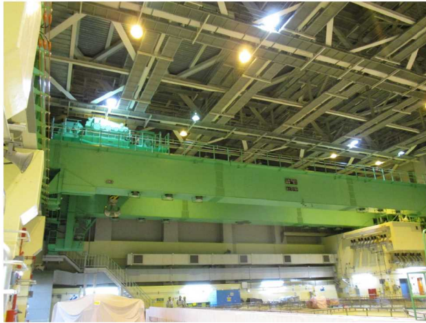
原子炉建屋クレーン外観
